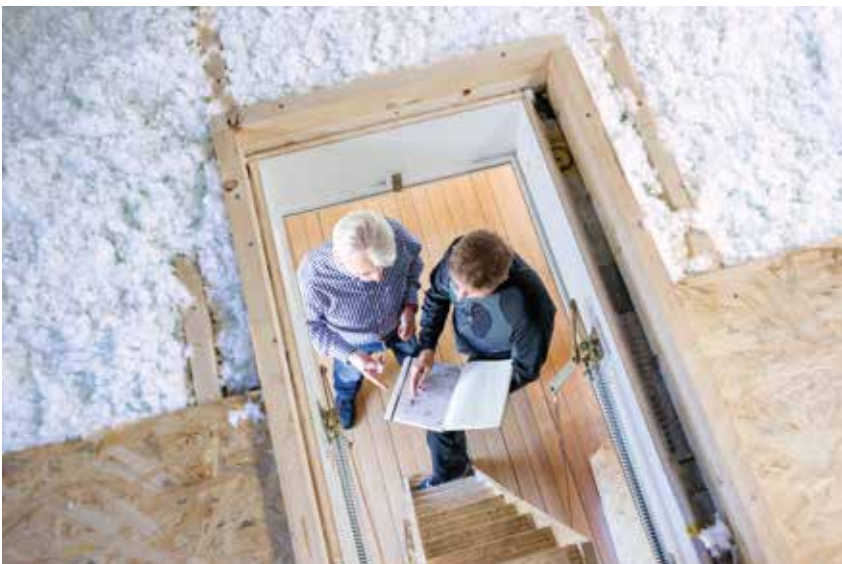
Verarbeitung auf der obersten Geschoßdecke, aufgeblasen auf ISOVER Vario® KM Duplex UV Klimamembran
